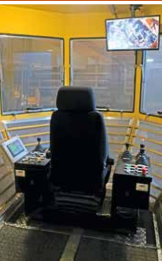
Кабина управления литейного крана
